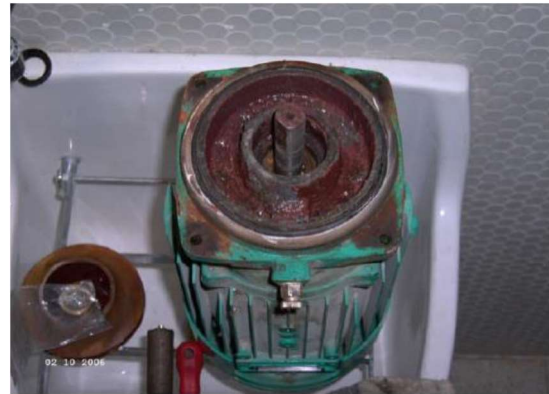
Abb. 33: Ausgefallene Umwälzpumpe aus einem Gebäudekühlkreis mit Kühldecken. D. Malinowsky.
