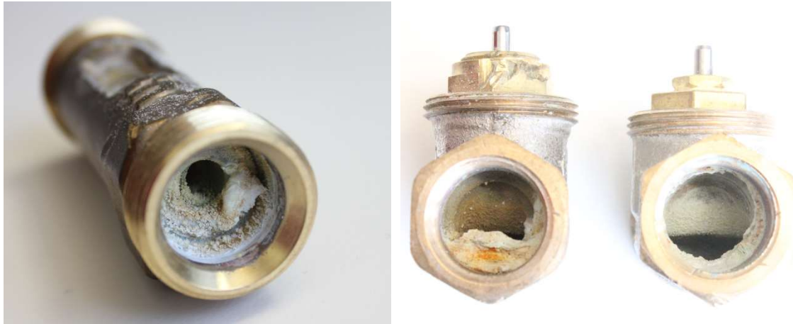
Abb. 34: Zugeseetzte Durchflussanzeige (links) und klemmende Ventile (rechts) aus dem System 11.1.
