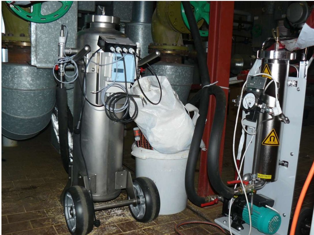
Abb. 57: Mobile Filterung und Osmoseentsalzung
